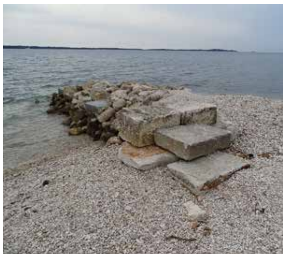
Slika 9: Postojeće stabilizacijsko pero
